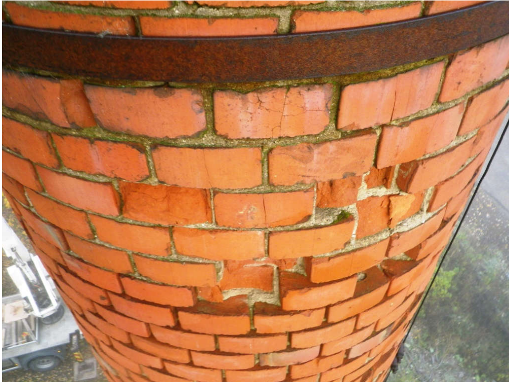
Kuva 6. ...mutta myös alempana havaittiin runsasta pintarapautumaa (kappaleiden irttoamisriski)
