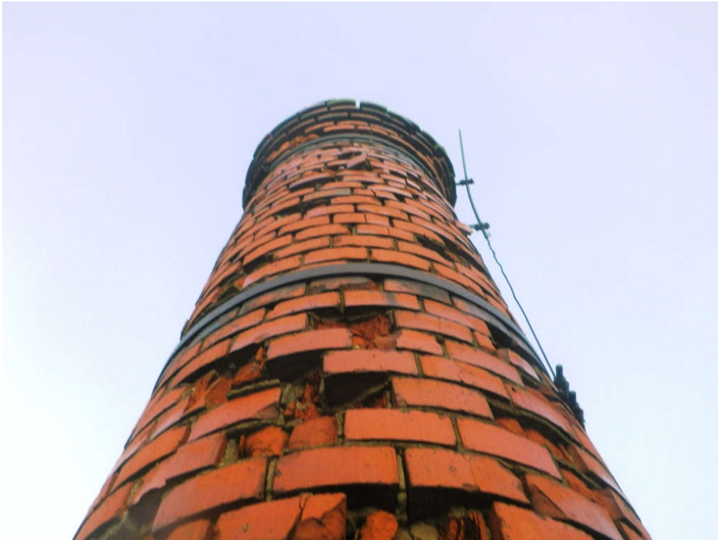
Kuva 3. Lämmityspiipun muurauksen rapautumista: pakkasvaurioita tiilissä ja laastissa. Piipun yläosa on kallistunut
