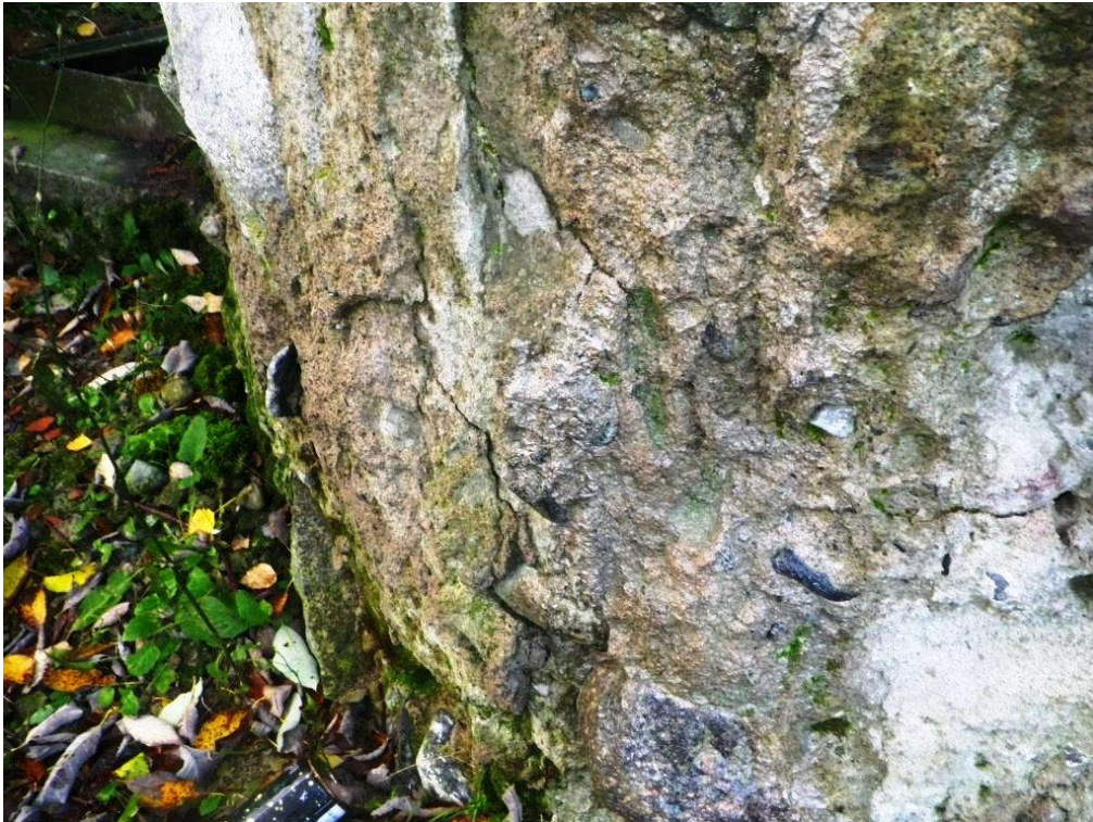
Kuva 1. Lähikuva piipun jalustan betonista; pintakerrokset ovat täysin rapautuneet ja pudonneet alas, pinnassa syviä halkeamia. Jalustan betoni on kauttaaltaan karbonatisoitunut ja betonissa todettiin pitkälle edennyttä pakkarapautumaa (vetolujuus näytteessä oli korkeintaan 0,6 MN/m 2 )
