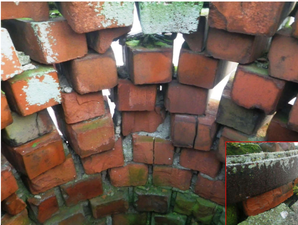
Kuva 4. Piipun yläpäästä on paikoin muurauslaasti pudonnut alas; yläosa voi pudota
