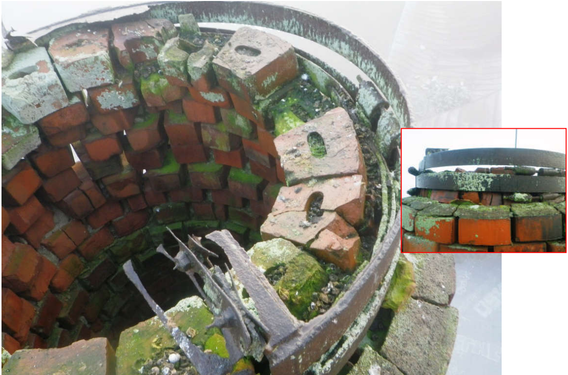
Kuva 5. Piipun yläosaa; tapaturmariski putoavista tiilistä sekä jossain vaiheessa jopa teräs-vanteesta. Varsinkin yläosa on purkaantumassa...
