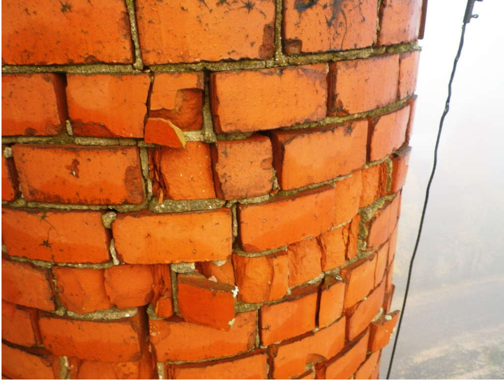
Kuva 7. Ohuthietutkimuksen mukaan tiilien luokka on 2 (VTT:n punatiilen mikrorakenteen perusteella määrittämä luokitus, index 0-3 (VTT julkaisu 1624 -95), eli lähes heikoin luokka. Laastin kuntoluokka todettiin välttäväksi (pakkasrasituksen heikentämä)
