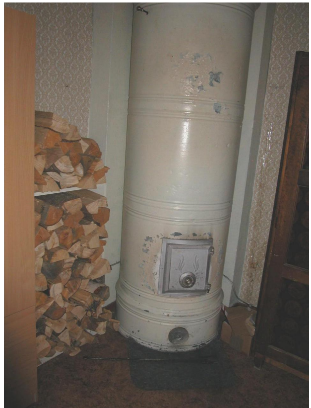
Kamarin pönttöuuni huoneistossa A. Asuntojen lämmitys perustuu huonekohtaisiin uuneihin.
