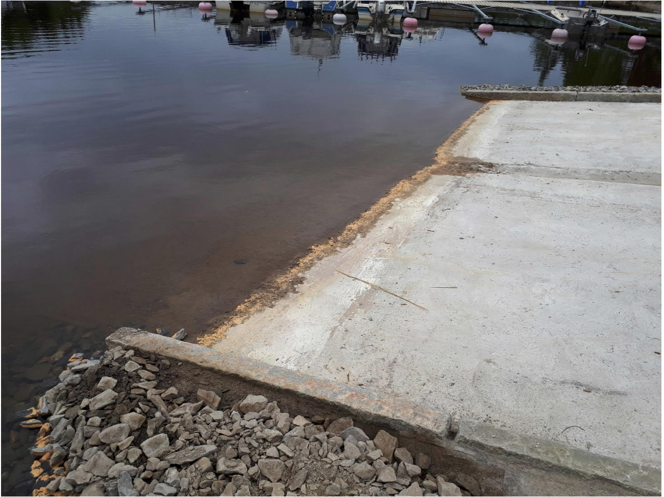
Kuva 2 Luiskan kunto luovutuksen yhteydessä 23.5.2019. Luiskan betoniosa vesirajassa on puhdas järven pinnalta kasautunutta eloperäistä roskaa lukuunottamatta.
