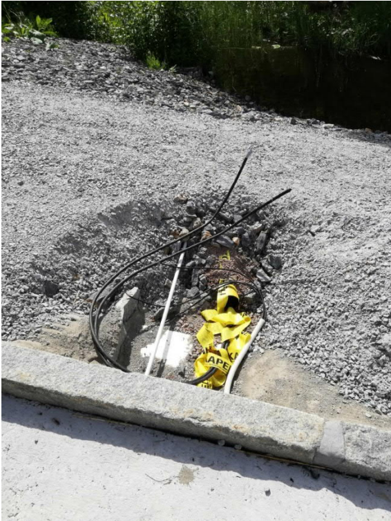
Kuva 6 Luiskan lämmityskaapelit olivat vielä kytkemättä 2.7.2019.
