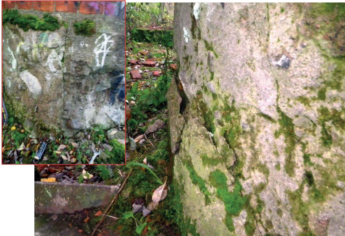
Kuva 25. Tikkutehtaan piipun perustusta; pakkasrapautumaa ja suuria halkeamia
