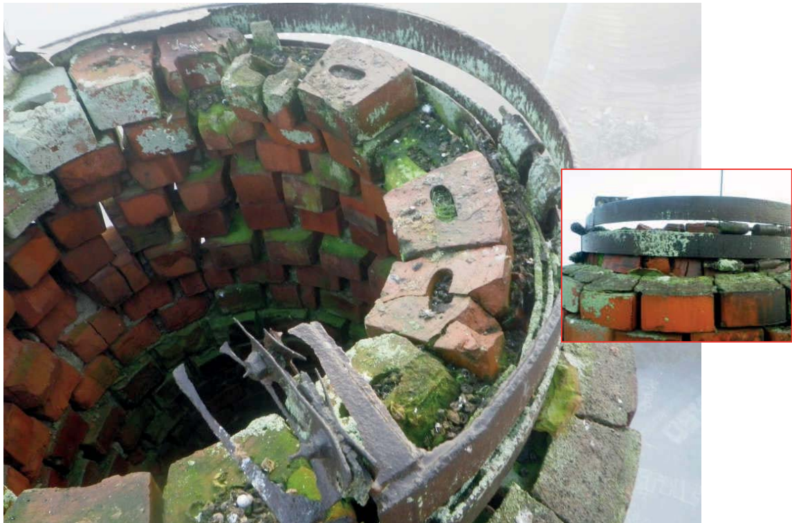
Kuva 28. Piipun yläosaa; tapaturmariski putoavista tiilistä sekä jossain vaiheessa jopa teräsvanteesta. Varsinkin yläosa on purkaantumassa...
