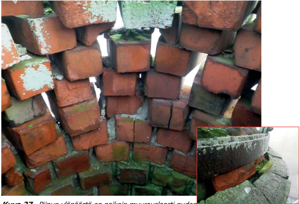
Kuva 27. Piipun yläpäästä on paikoin muurauslaasti pudonnut alas; yläosa voi pudota
