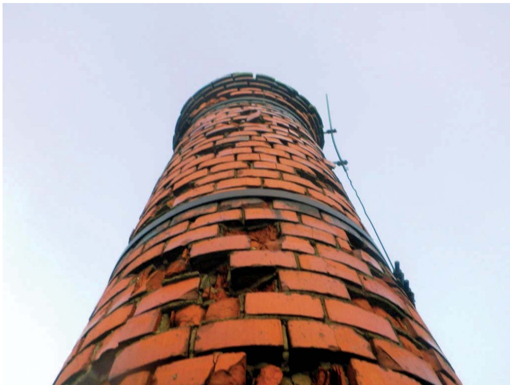
Kuva 26. Lämmityspiipun muurauksen rapautumista: pakkasvaurioita tiilissä ja laastissa
