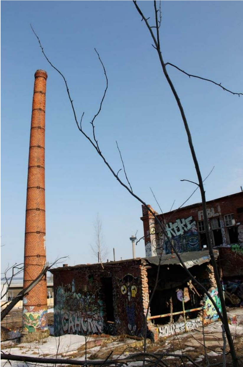
Tulitikkutehtaan kallistunut piippu kuvattuna lännestä 15.4.2018
