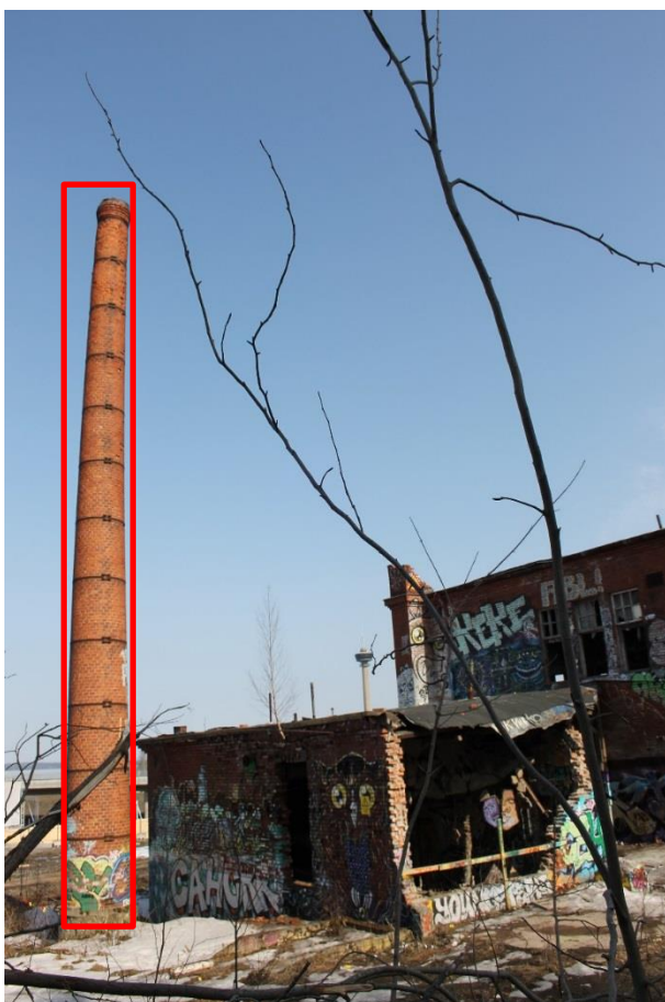
Kuva 2.4 Tulitikkutehtaan kallistunut piippu kuvattuna lännestä 15.4.2018
