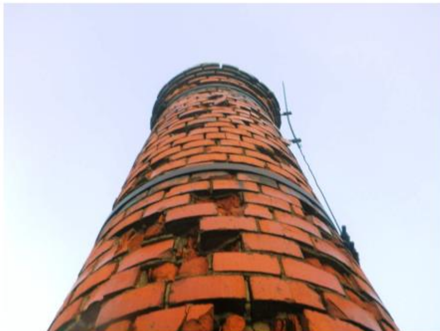
Kuva 26. Lämmityspiipun muurauksen rapautumista: pakkasvaurioita tiilissä ja laastissa
