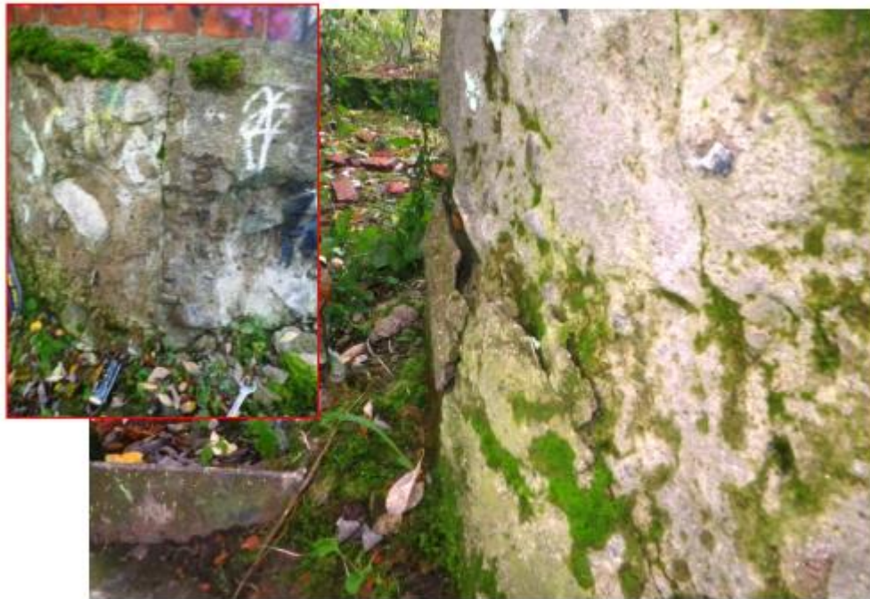
Kuva 25. Tikkutehtaan piipun perustusta; pakkasrapautumaa ja suuria halkeamia
