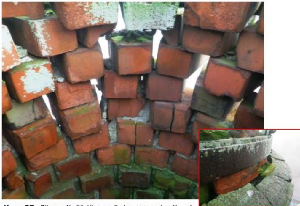
Kuva 27. Piipun yläpäästä on paikoin muurauslaasti pudonnut alas, yläosa voi puuota
