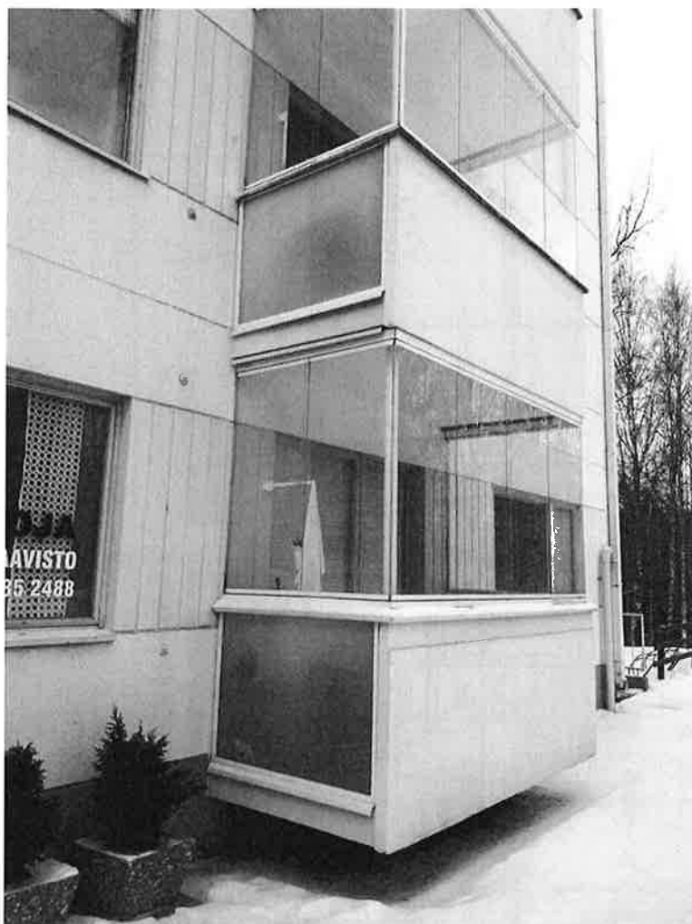
Kuva 11. Tornitalon parvekkeet tuuletusikkunoiden välittömässä läheisyydessä ja tupakansavulla mahdollista kulkea myös parvekkeelta toiselle.
