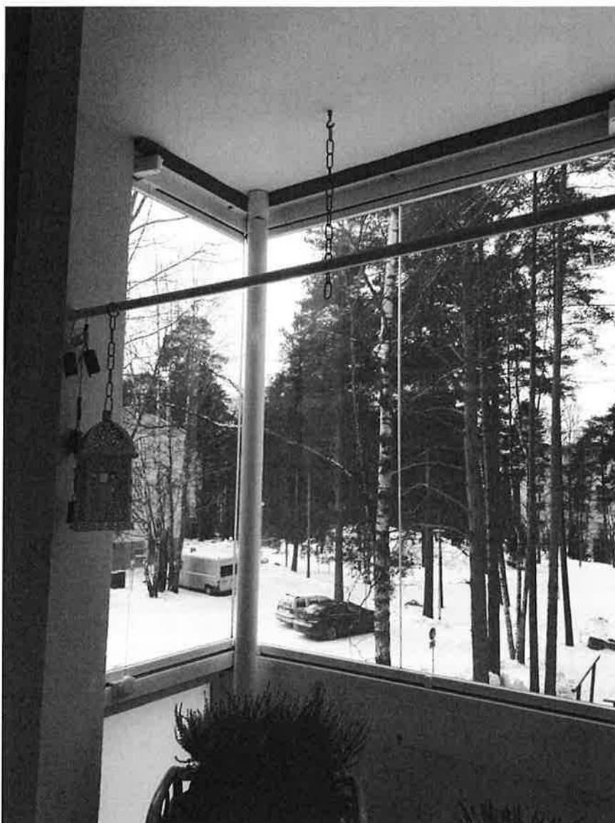
Kuva 7. Esimerkkikuva parvekkeelta, parvekelasitusten liitoskohdat epätiivä, joiden kautta tupakansavulla mahdollista kulkeutua parvekkeiden välillä.
