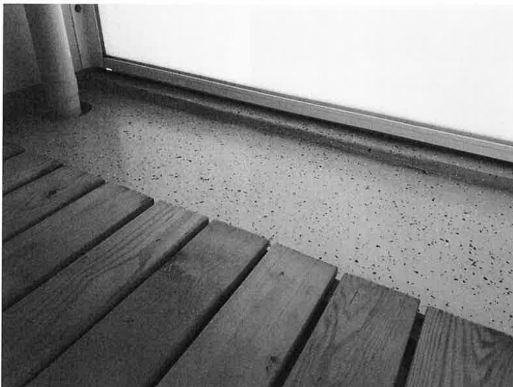
Kuva 8. Lasitusten alareunassa epätiiveyskohtia, joista tupakansavulla mahdollista kulkeutua parvekkeiden välillä.
