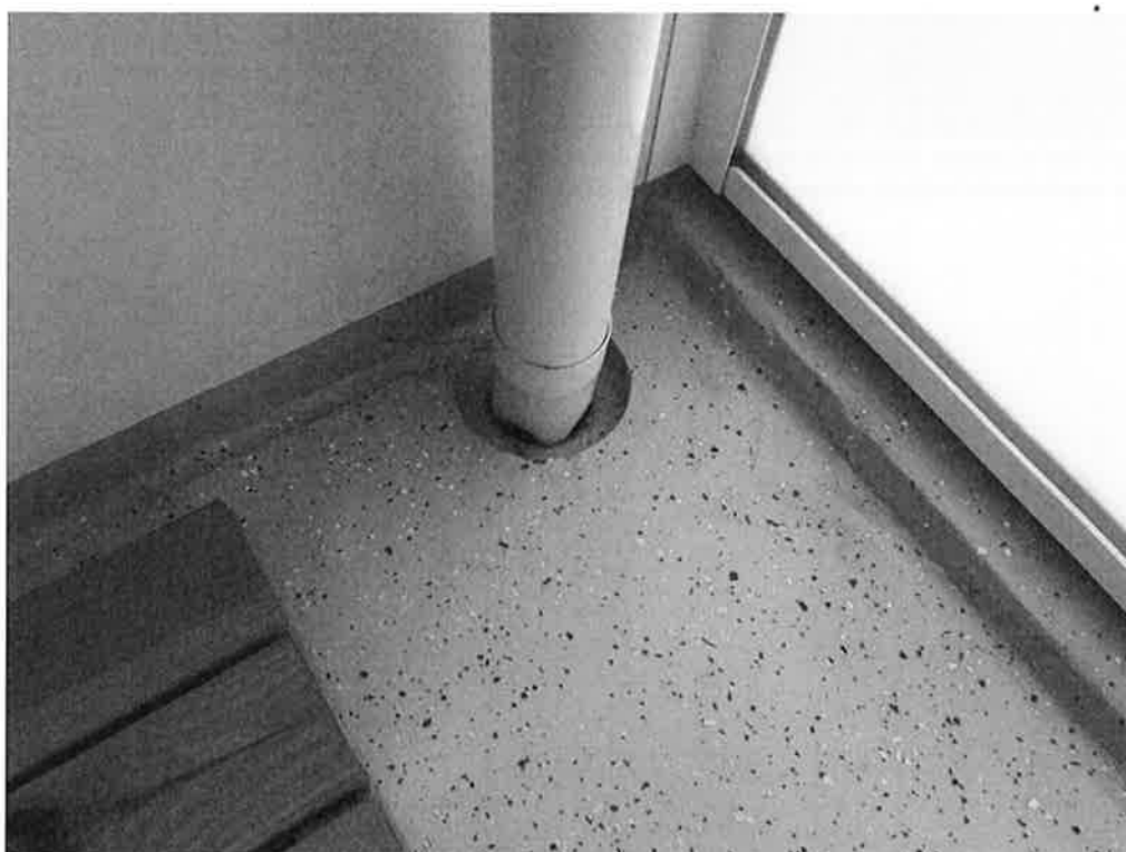
Kuva 9. parvekkeiden vedenpoistot epätiiveyskohtia, joiden kautta tupakansavulla mahdollista kulkeutua parvekkeiden välillä.
