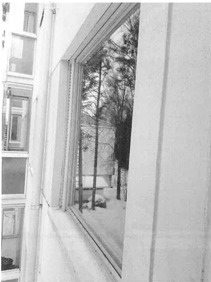
Kuva 10. Kuva parvekkeelta otettua, tuuletusikkunat viereisissä ikkunoissa, jolloin ylösnouseva tupakansavu helposti pääsee huoneistoihin sisälle tuuletustilanteessa.
