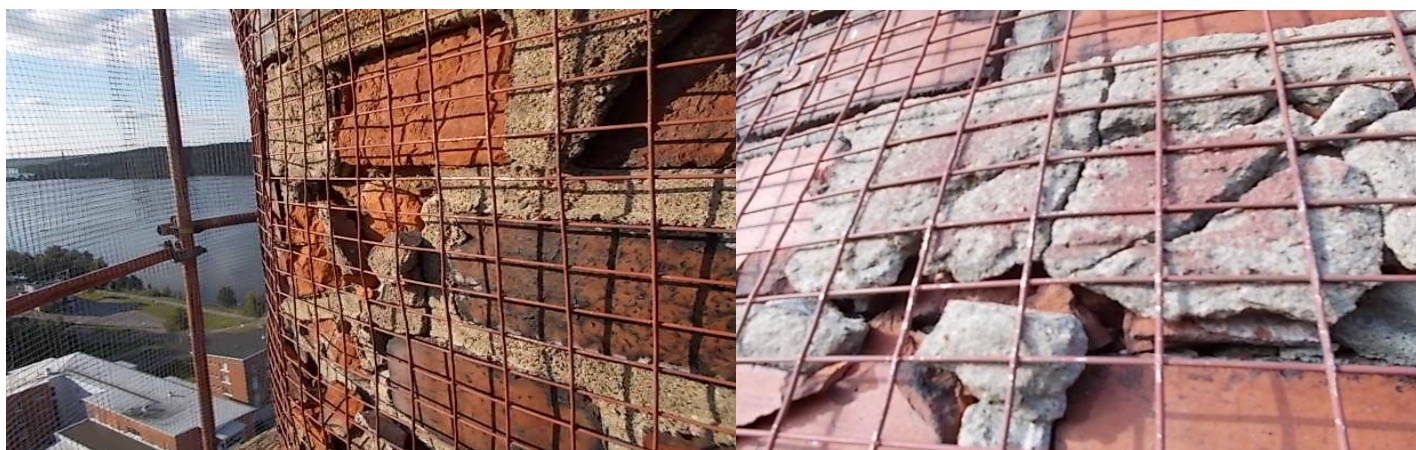
Kuvat: Rapautunutta ulkopintaa
