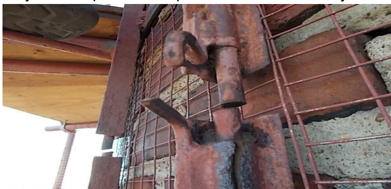
Kuva: Ulkoiset voimat ja korroosio vaikuttaneet piipun varusteisiin
