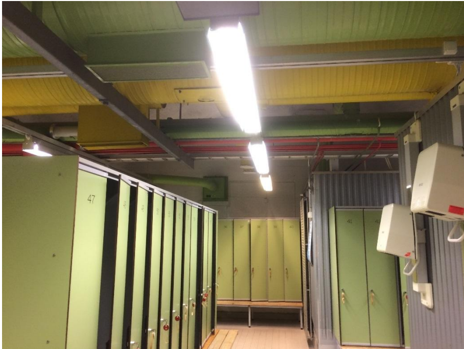
Kuva 1. Tilojen valaistus on toteutettu loisteputkivalaisimin.
