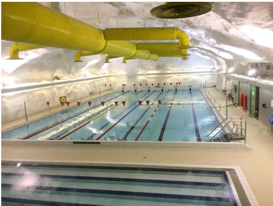
Kuva 2. Allasosaston valaistus on toteutettu kattoa valasevin valonheittimin ja loisteputkivalaisimin.
