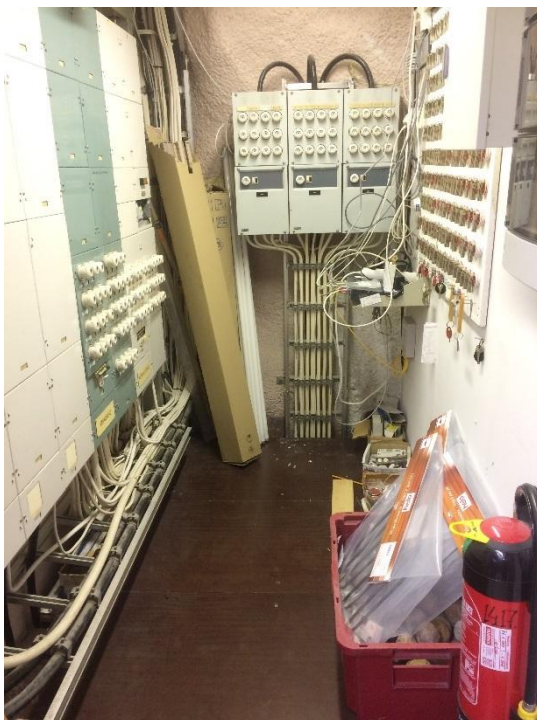
Kuva 4. Myös uimahallin keskustilassa on sinne kuulumatonta tavaraa.
