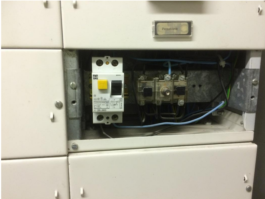
Kuva 5. Aukko keskuksessa. Jännitteiset ruuvit ovat kosketussuojaamattomia
